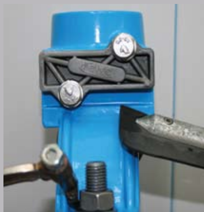
test nezjistil póry ve vrstvě barvy
